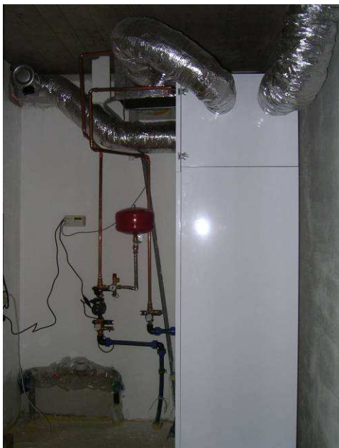
Technická místnost s kompaktní rekuperační jednotkou Nilan a solankovým zemním výměníkem.
